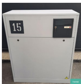
Figure 6 - Exemple d'habillage métallique des coffrets et boîtes aux lettres
